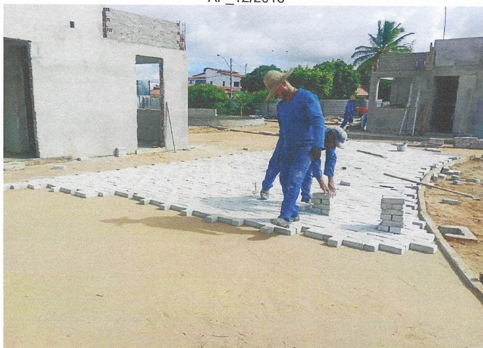
Foto 04 – EXECUÇÃO DE PÁTIO/ESTACIONAMENTO EM PISO INTERTRAVADO, COM BLOCO RETANGULAR COR NATURAL DE 20 X 10 CM, ESPESSURA 6 CM. AF_12/2015
