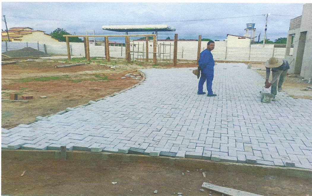
Foto 06 – EXECUÇÃO DE PÁTIO/ESTACIONAMENTO EM PISO INTERTRAVADO, COM BLOCO RETANGULAR COR NATURAL DE 20 X 10 CM, ESPESSURA 6 CM. AF_12/2015
