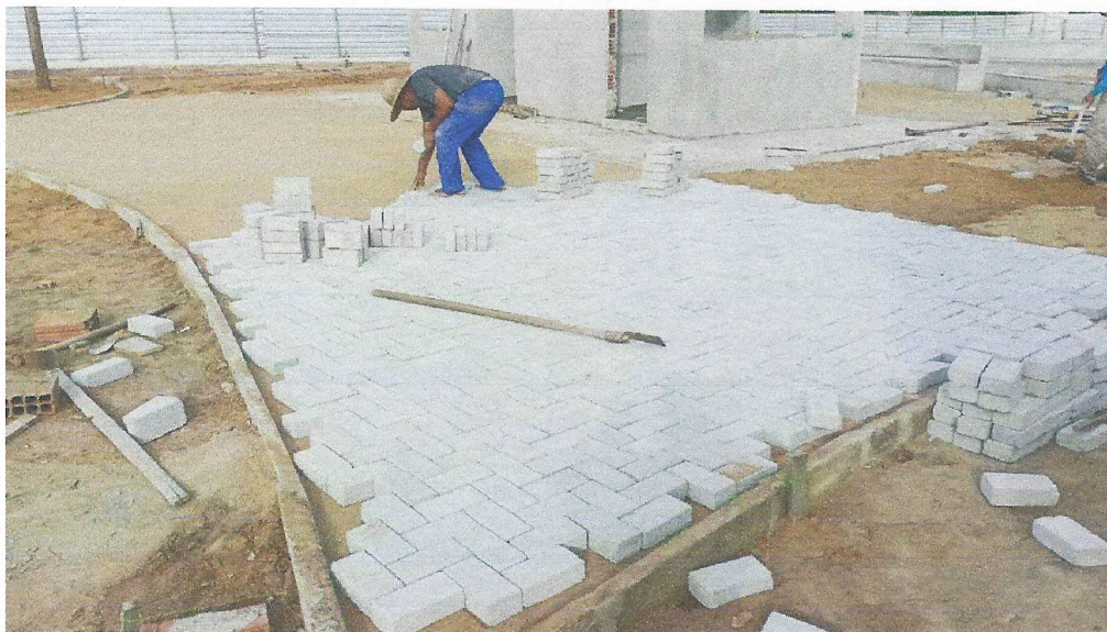
Foto 03 – EXECUÇÃO DE PÁTIO/ESTACIONAMENTO EM PISO INTERTRAVADO, COM BLOCO RETANGULAR COR NATURAL DE 20 X 10 CM, ESPESSURA 6 CM. AF_12/2015
