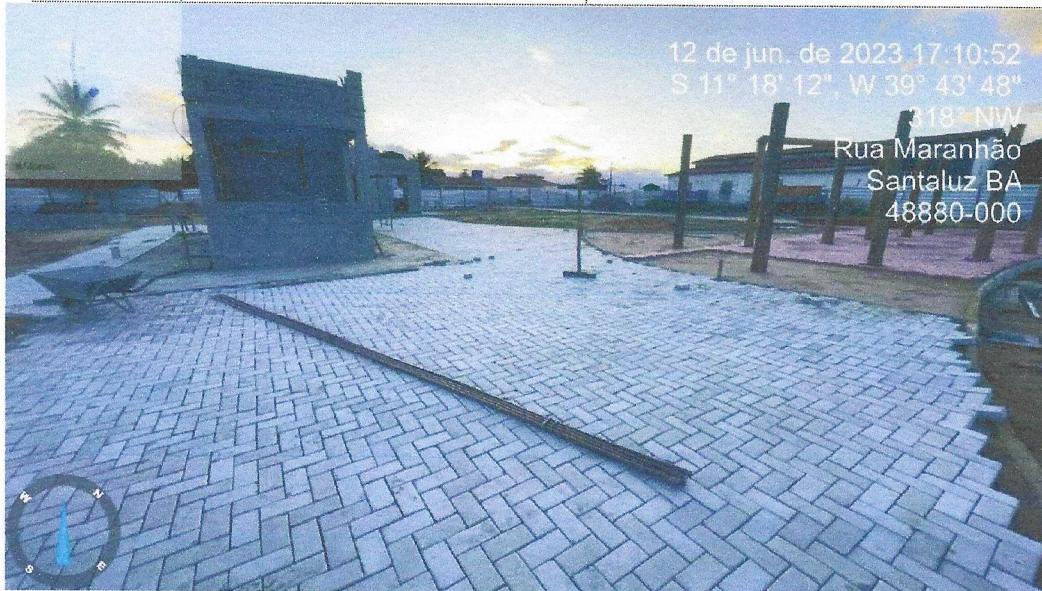
Foto 07 – EXECUÇÃO DE PÁTIO/ESTACIONAMENTO EM PISO INTERTRAVADO, COM BLOCO RETANGULAR COLORIDO DE 20 X 10 CM, ESPESSURA 6 CM. AF_12/2015
