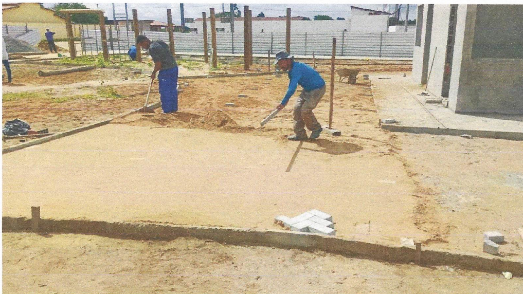
Foto 02 – ATERRO E COMPACTAÇÃO DE COLCHÃO DE AREIA PARA ASSENTAMENTO DE PISO INTERTRAVADO.
