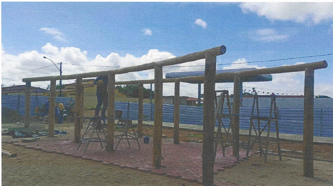
Foto 24 – EXECUÇÃO DE PASSEIO (CALÇADA) OU PISO DE CONCRETO COM CONCRETO MOLDADO IN LOCO, FEITO EM OBRA, ACABAMENTO CONVENCIONAL, ESPESSURA 6 CM, ARMADO. AF_07/2016
