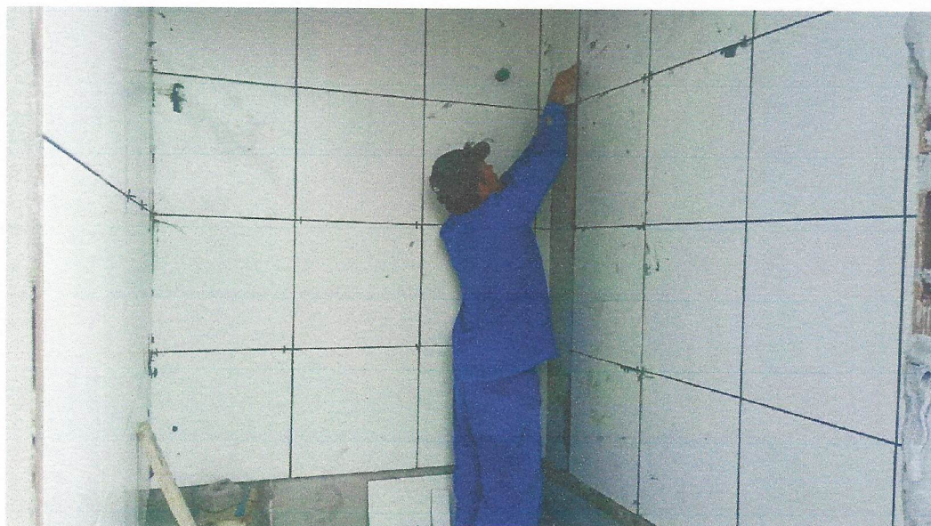
Foto 20 – REVESTIMENTO CERÂMICO PARA PAREDES INTERNAS COM PLACAS TIPO ESMALTADA EXTRA DE DIMENSÕES 33X45 CM APLICADAS EM AMBIENTES DE ÁREA MAIOR QUE 5 M 2 NA ALTURA INTEIRA DAS PAREDES. AF_06/2014
