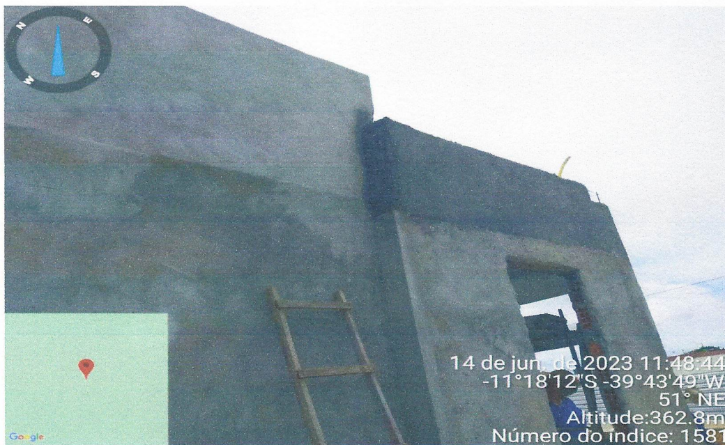
Foto 18 – ALVENARIA DE VEDAÇÃO DE BLOCOS CERÂMICOS FURADOS NA HORIZONTAL DE 9X19X29 CM (ESPESSURA 9 CM) E ARGAMASSA DE ASSENTAMENTO COM PREPARO EM BETONEIRA. AF_12/2021
