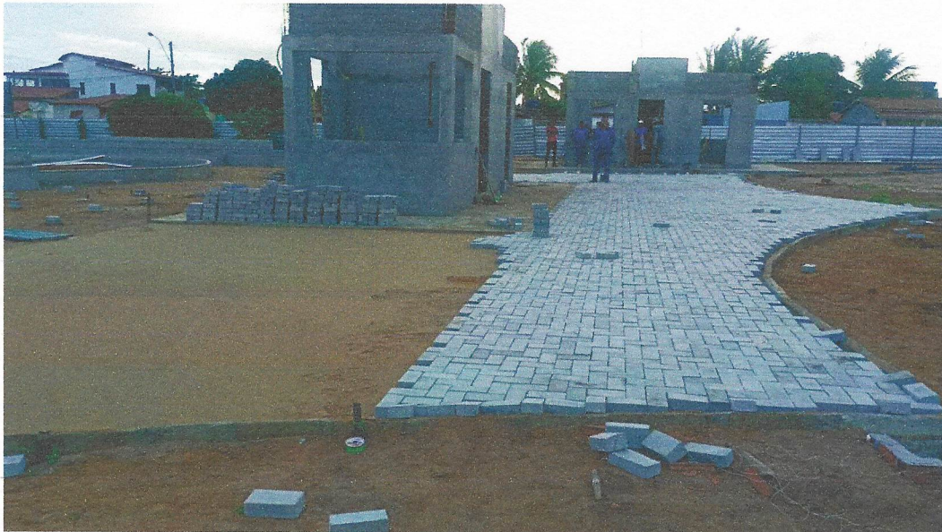
Foto 05 - EXECUÇÃO DE PÁTIO/ESTACIONAMENTO EM PISO INTERTRAVADO, COM BLOCO RETANGULAR COR NATURAL DE 20 X 10 CM, ESPESSURA 6 CM. AF_12/2015
