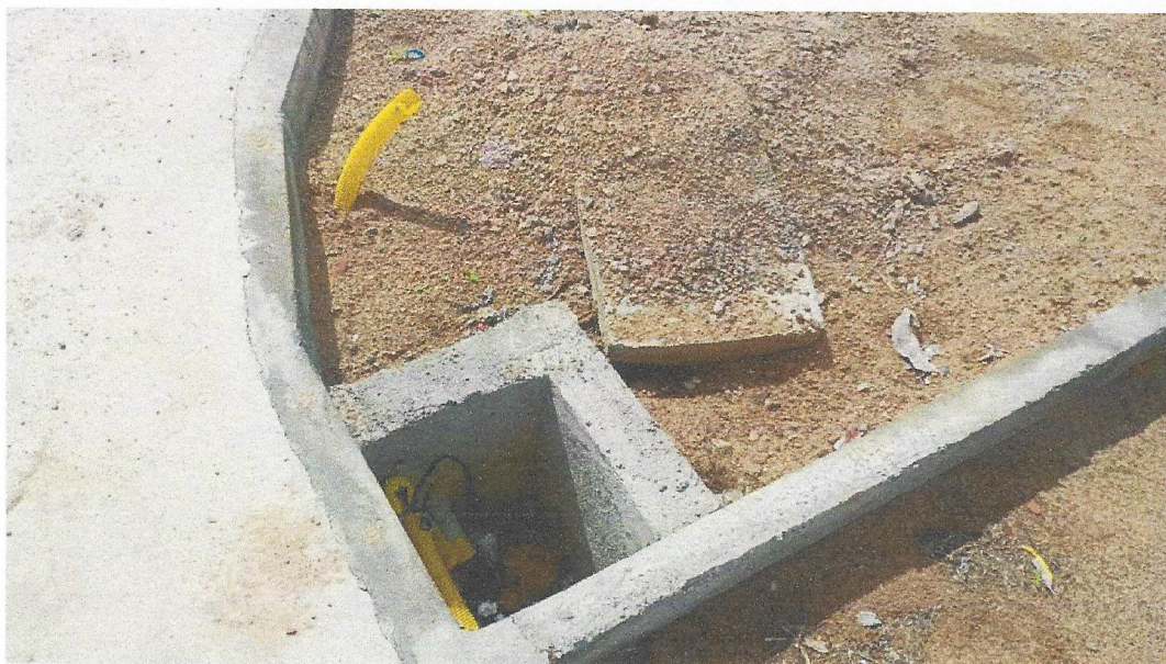
Foto 11 – Caixa de passagem em alvenaria de tijolos maciços esp. = 0,12m, dim. int. = 0,30 x 0,30 x 0,30m
