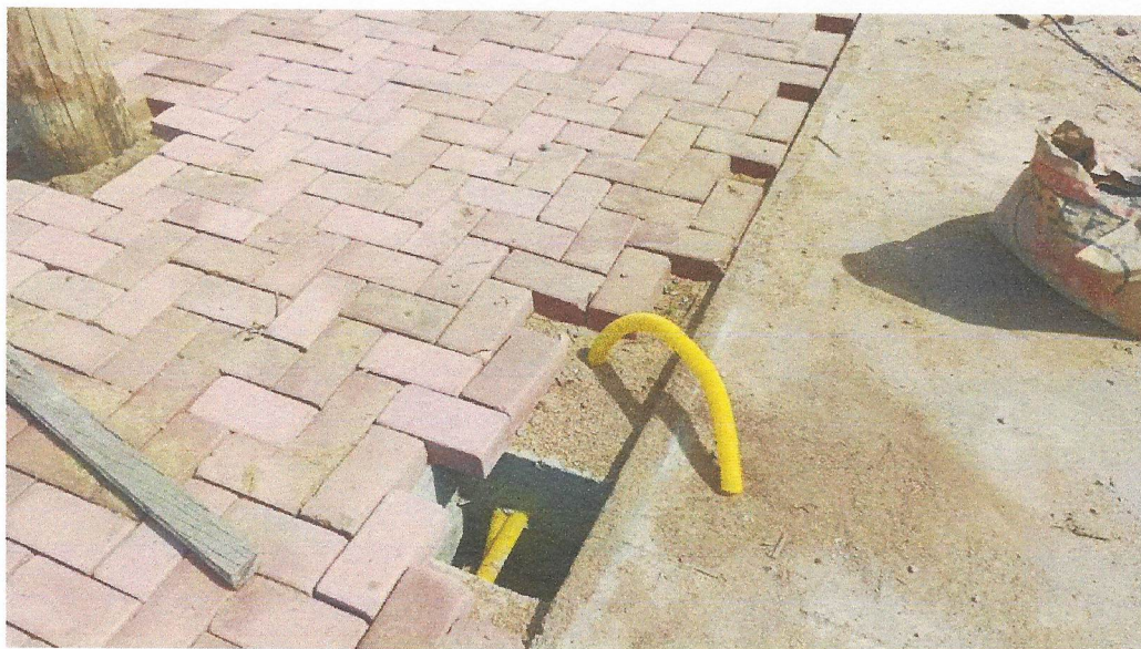
Foto 10 – Caixa de passagem em alvenaria de tijolos maciços esp. = 0,12m, dim. int. = 0,30 x 0,30 x 0,30m
