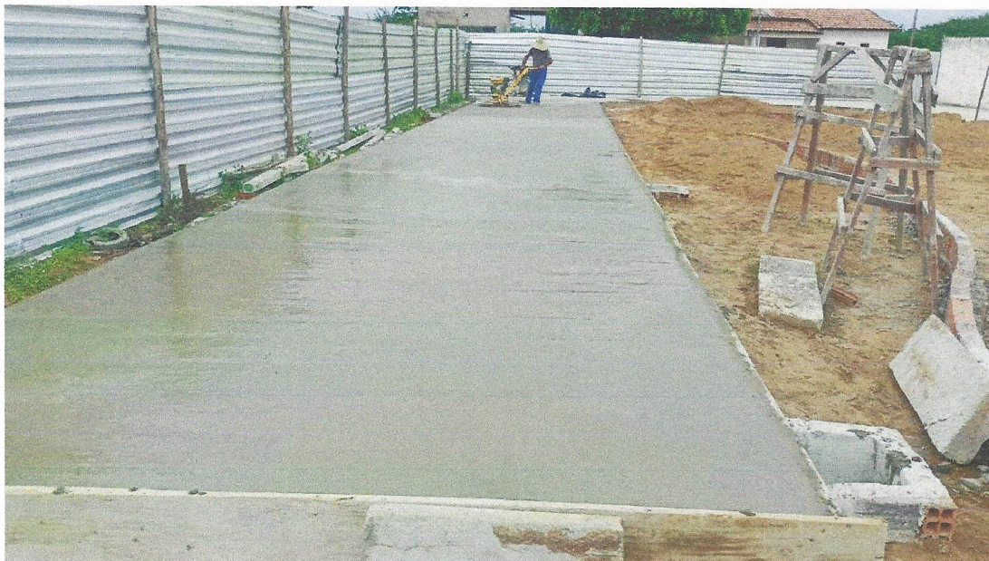
Foto 33 - EXECUÇÃO DE PASSEIO (CALÇADA) OU PISO DE CONCRETO COM CONCRETO MOLDADO IN LOCO, FEITO EM OBRA, ACABAMENTO CONVENCIONAL, ESPESSURA 6 CM, ARMADO. AF_07/2016
